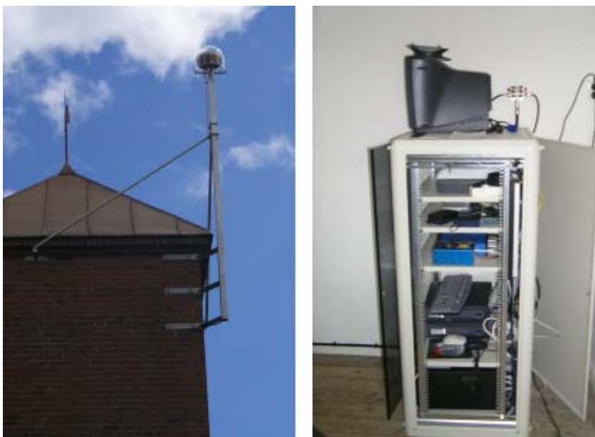
Figur 5: T.v. Stationen i Skillinge är en av de förenklade projektstationerna i SKAN-RTK – 2. T.h. Stationsutrustningen är samlad i ett datorrack, likadant på alla stationer, vilket underlättar service.
